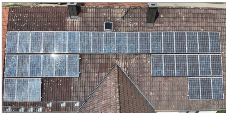
Überflug über Photovoltaikanlage Standardansicht Weitwinkelkamera der Drohne
