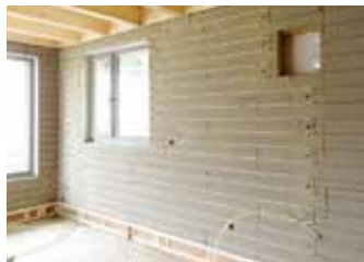
Lehmwand mit Wandheizung
