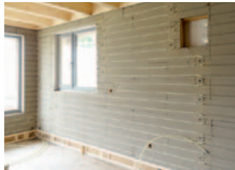
Lehmwand mit Wandheizung
