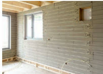
Lehmwand mit Wandheizung
