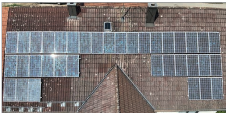
Überflug über Photovoltaikanlage Standardansicht Weitwinkelkamera der Drohne
