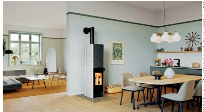
Wasserführende Kamine können die Zentralheizung entlasten
