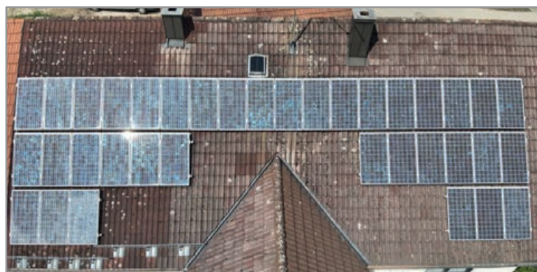
Überflug über Photovoltaikanlage Standardansicht Weitwinkelkamera der Drohne
